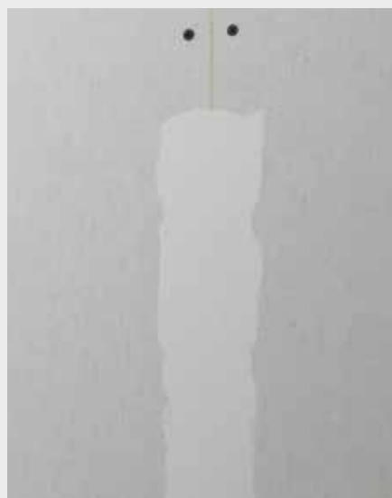
Teilweise vorgenommene Fugenspachtelung
